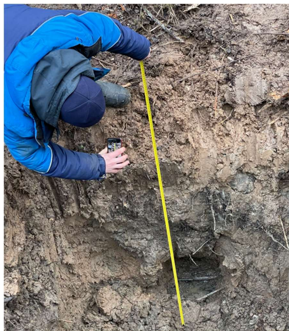
Рис. 5. Фиксация обнаруженного повреждения после проведённых измерений
